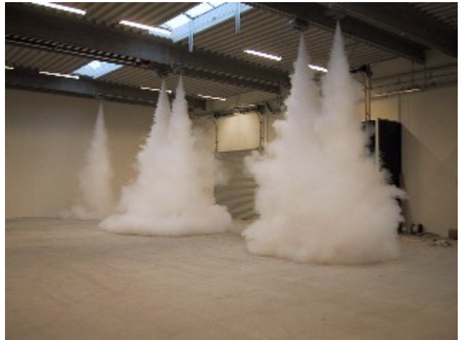
Ejemplo de protección con niebla en un almacén de grandes dimensiones. Los generadores de niebla están instalados en las puertas de entrada y detienen a los invitados inesperados.
